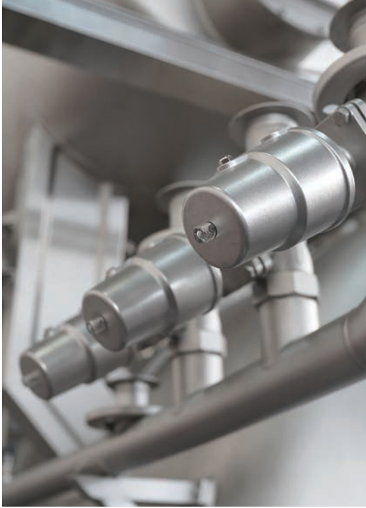
Isı Eşanjörü Geri Dönüş Sistemi / Heat Exchanger Return System
